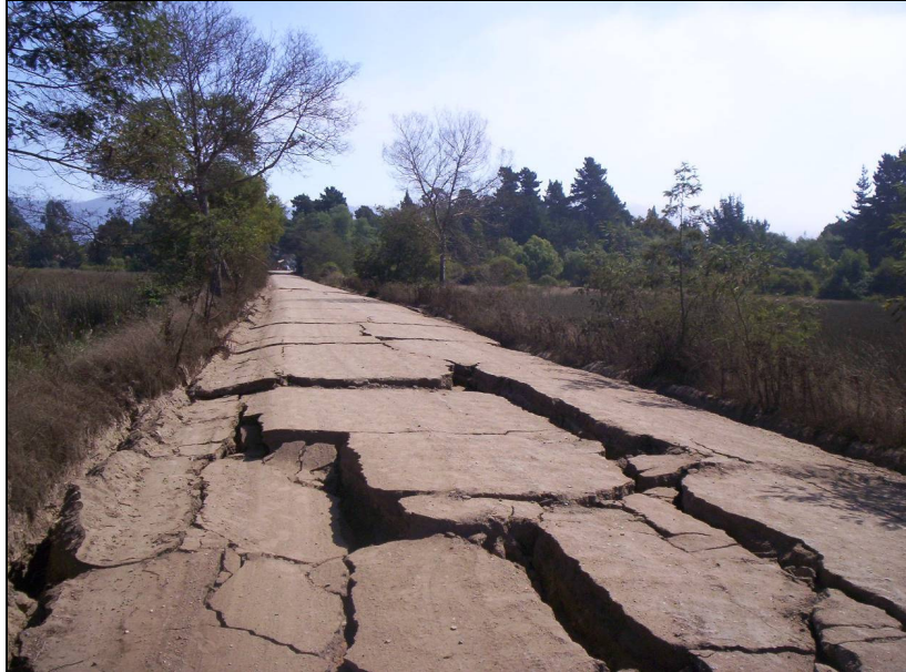
Figura 13 – Resultado do terremoto no Chile, ocorrido em 27 de fevereiro de 2010, no caminho que liga a lagoa Torca ao pueblo de Llico. Fonte: Mauricio R. Vuscovich, 2010.
