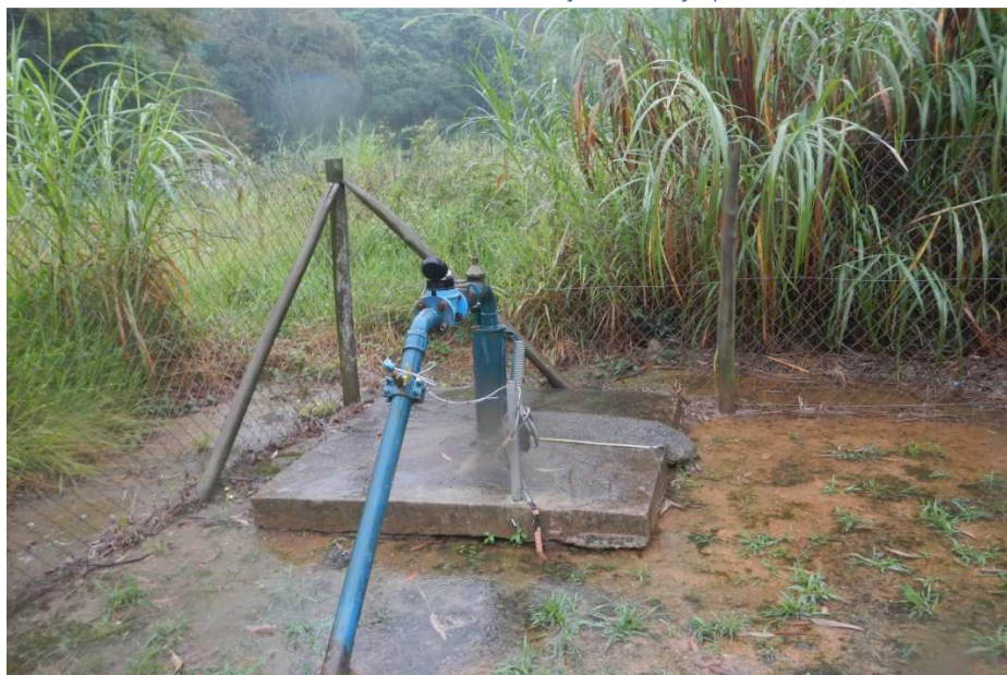
Vista das Instalações do Poço P-18.
