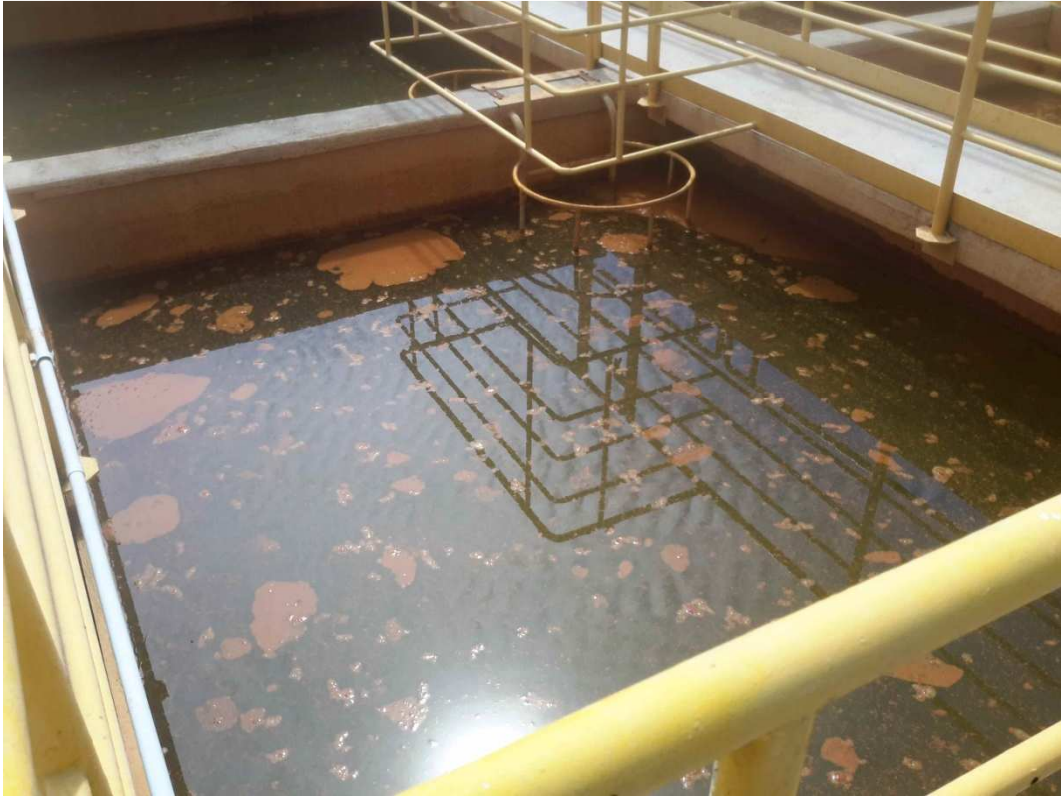
Detalhe da Estação de Tratamento de Água - Câmara de Decantação com Lamelas
