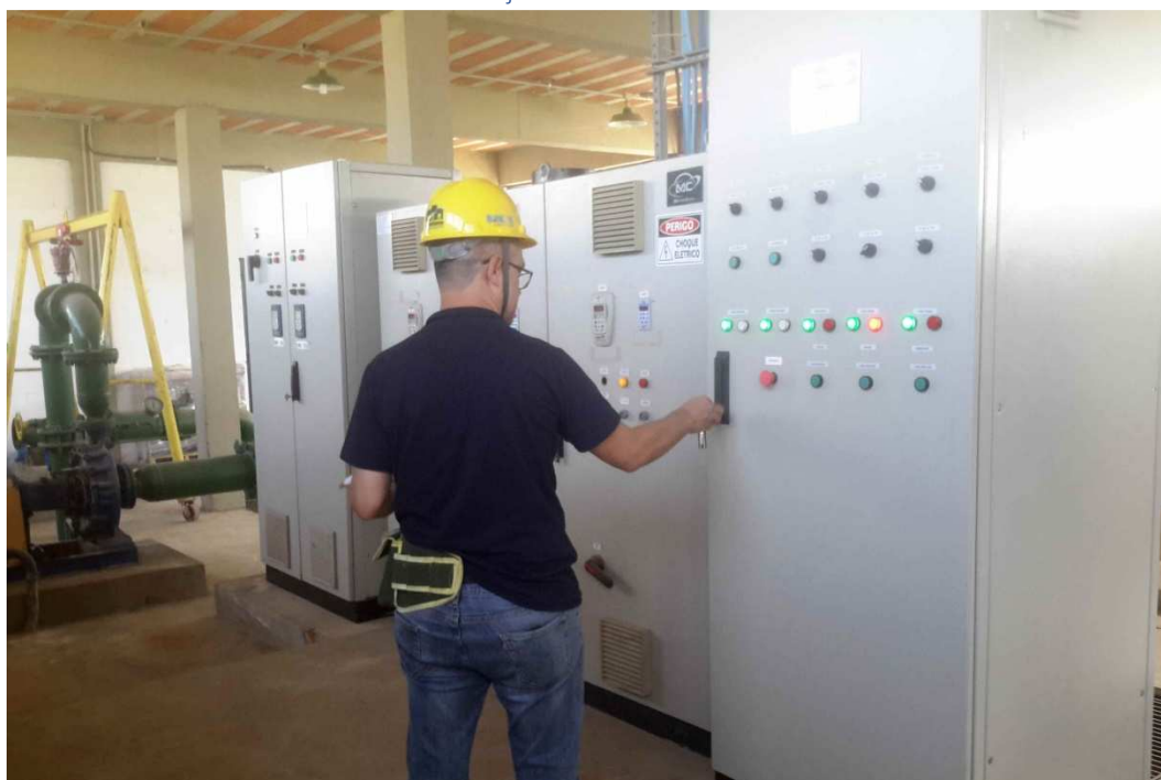
Vista interna das instalações da EEAT – ETA.
