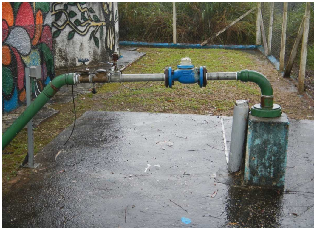
Vista do Quadro de Comando do Poço P-10.
