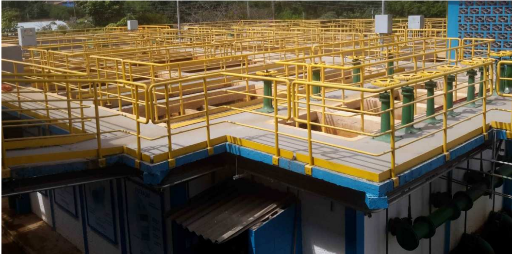
Vista Parcial da Estação de Tratamento de Água Jardim Cruzeiro na sede da Saneaqua.
