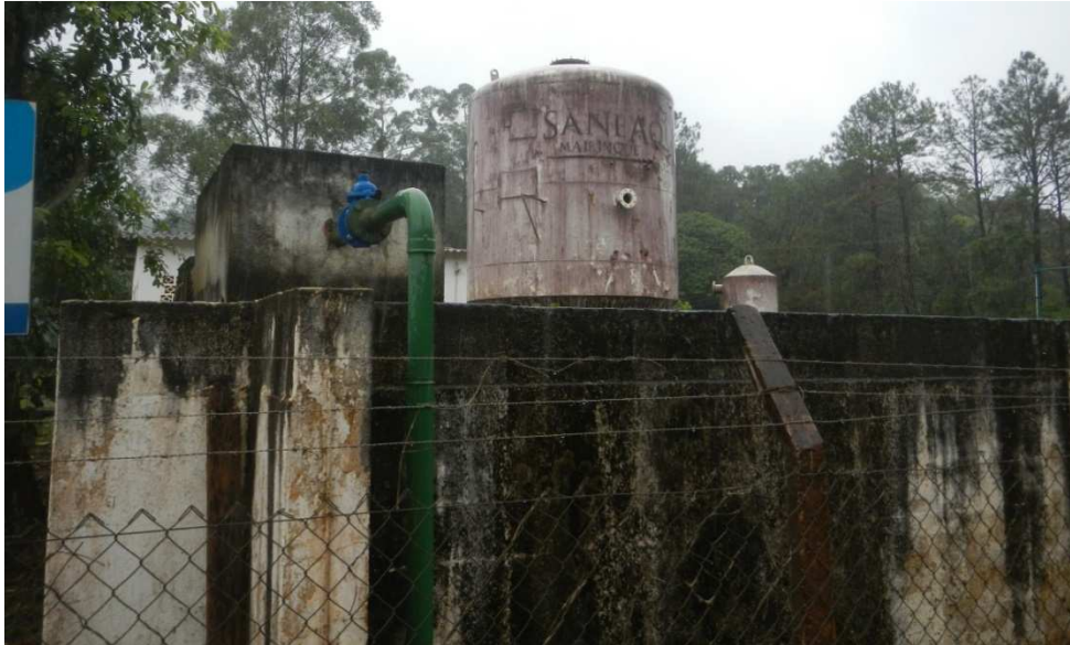
Vista de reservatório implantado na área da EEAT Vitória ZB.
