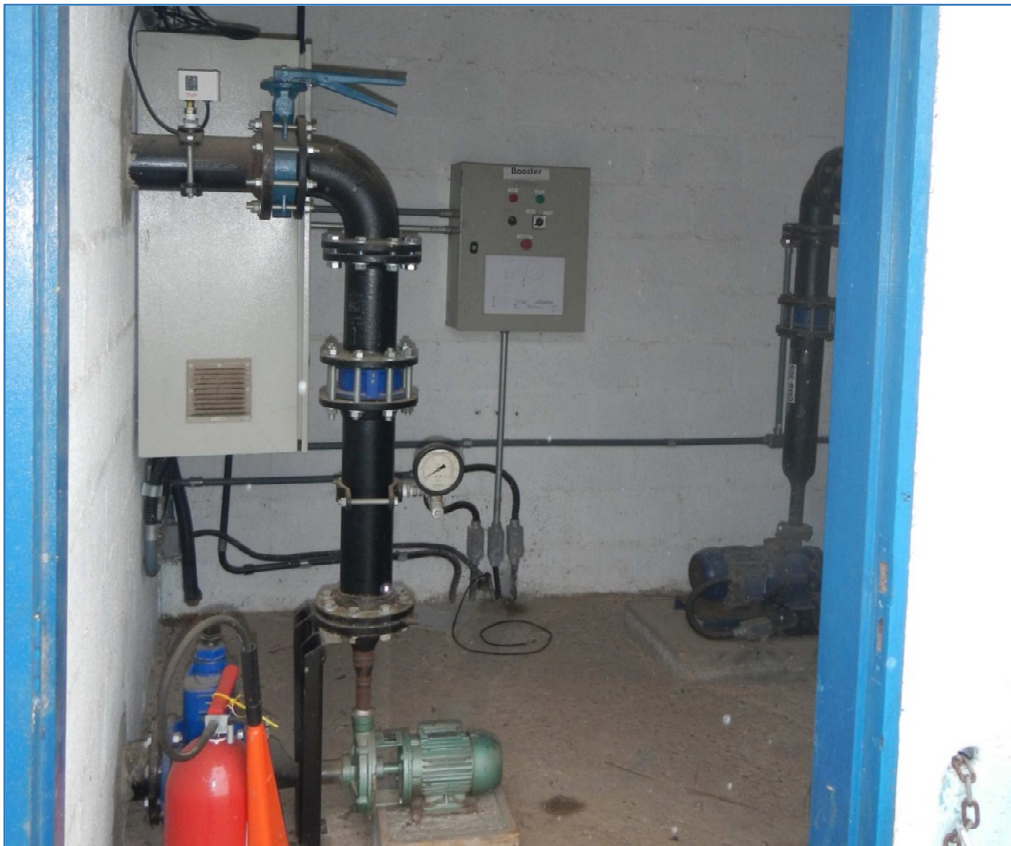
Vista interna das instalações da Booster– CR Dona Catarina.
