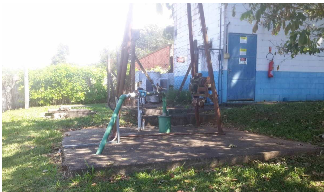
Vista do Poço P-3 implantado dentro das instalações da ETA.
