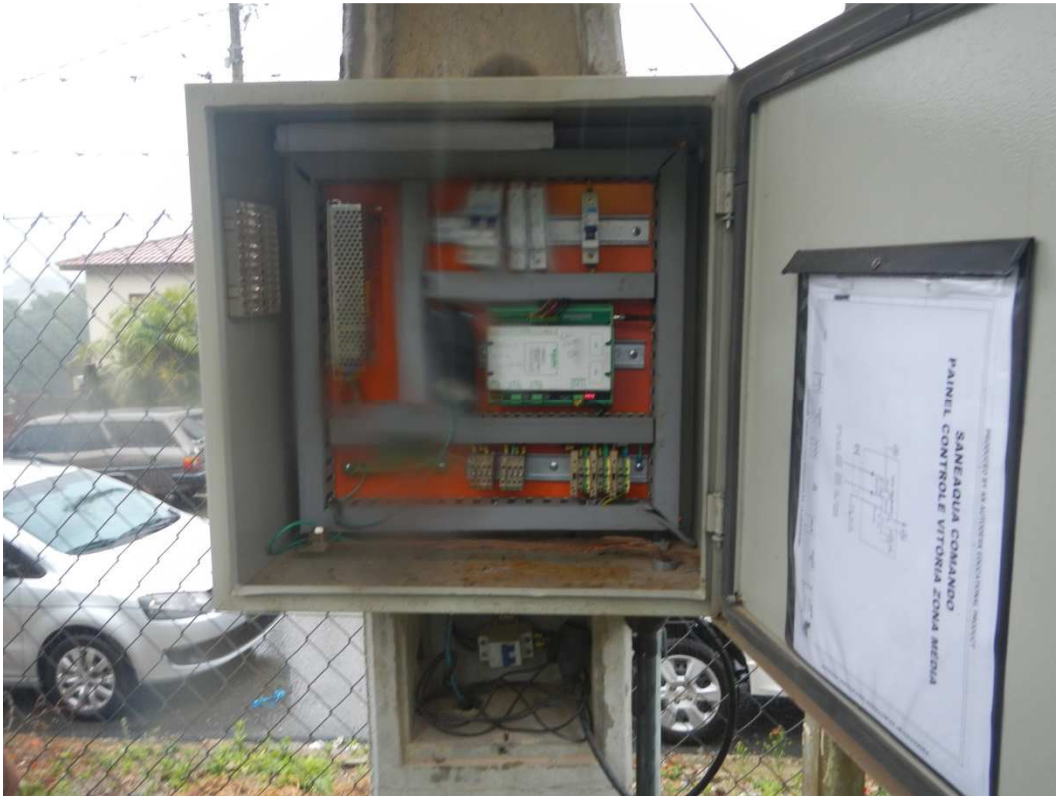
Vista interna do Painel de Controle EEAT Vitória ZB2.
