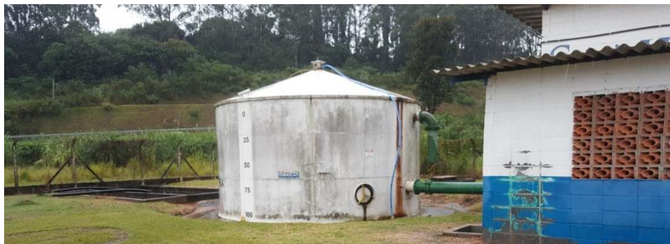
Vista do reservatório instalado na EEAT Ginásio.
