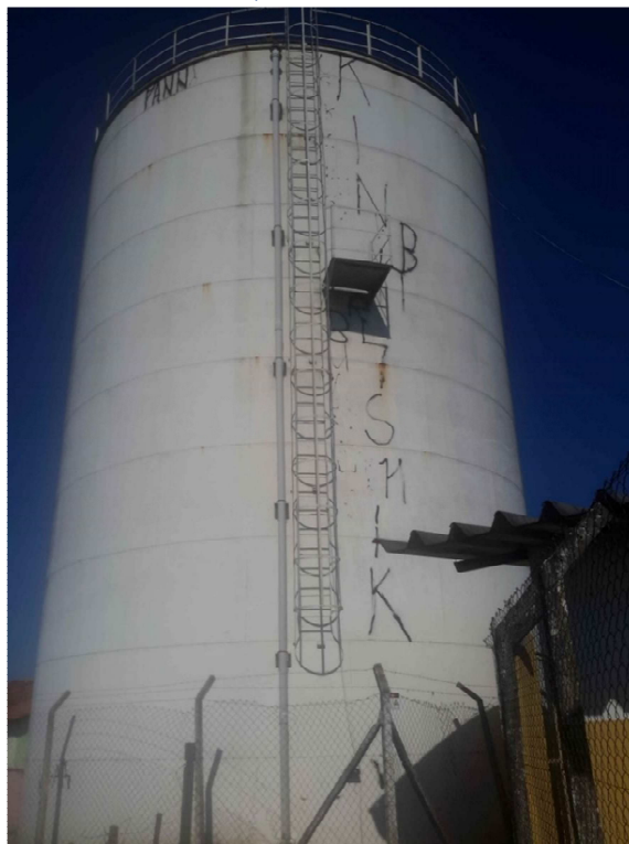
Vista do outro reservatório que compõe o CR Recanto 2 posicionado aos fundos.
