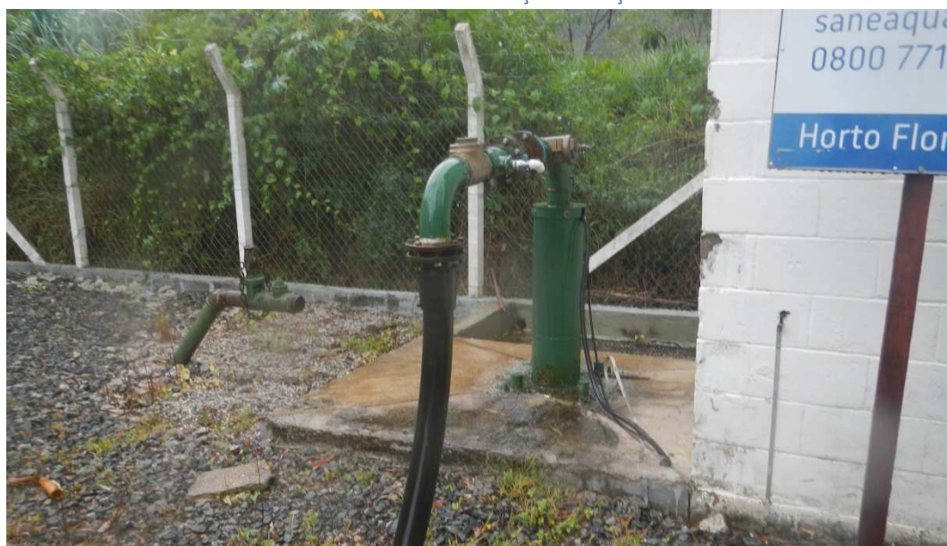
Vista das Instalações do Poço P-14.
