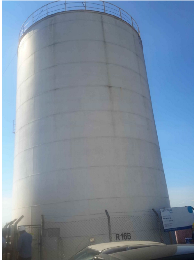
Vista do Reservatório R16B posicionado na frente do CR Recanto 2.
