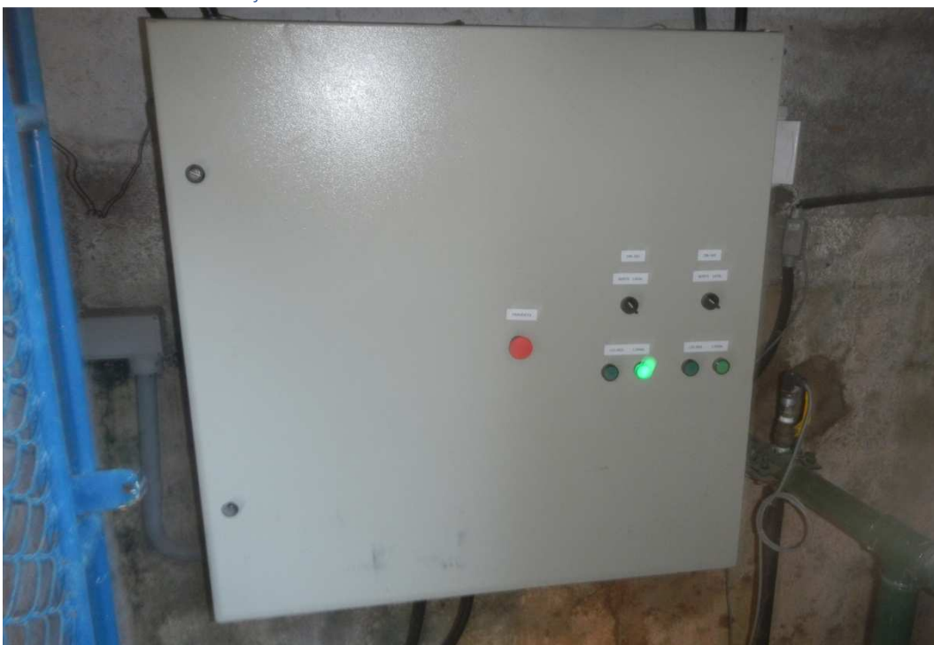
Vista interna das instalações da EEAT – CR Bombeiro.
