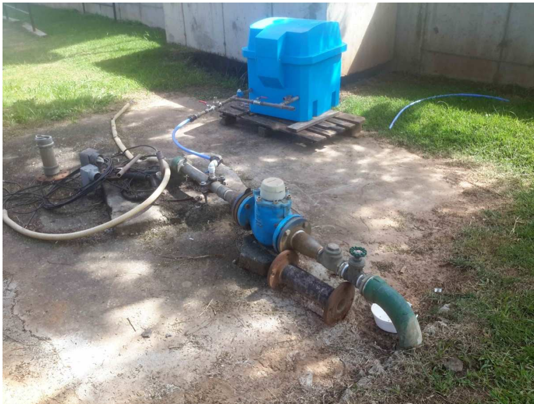
Vista do Poço P-1 implantado dentro das instalações da ETA.
