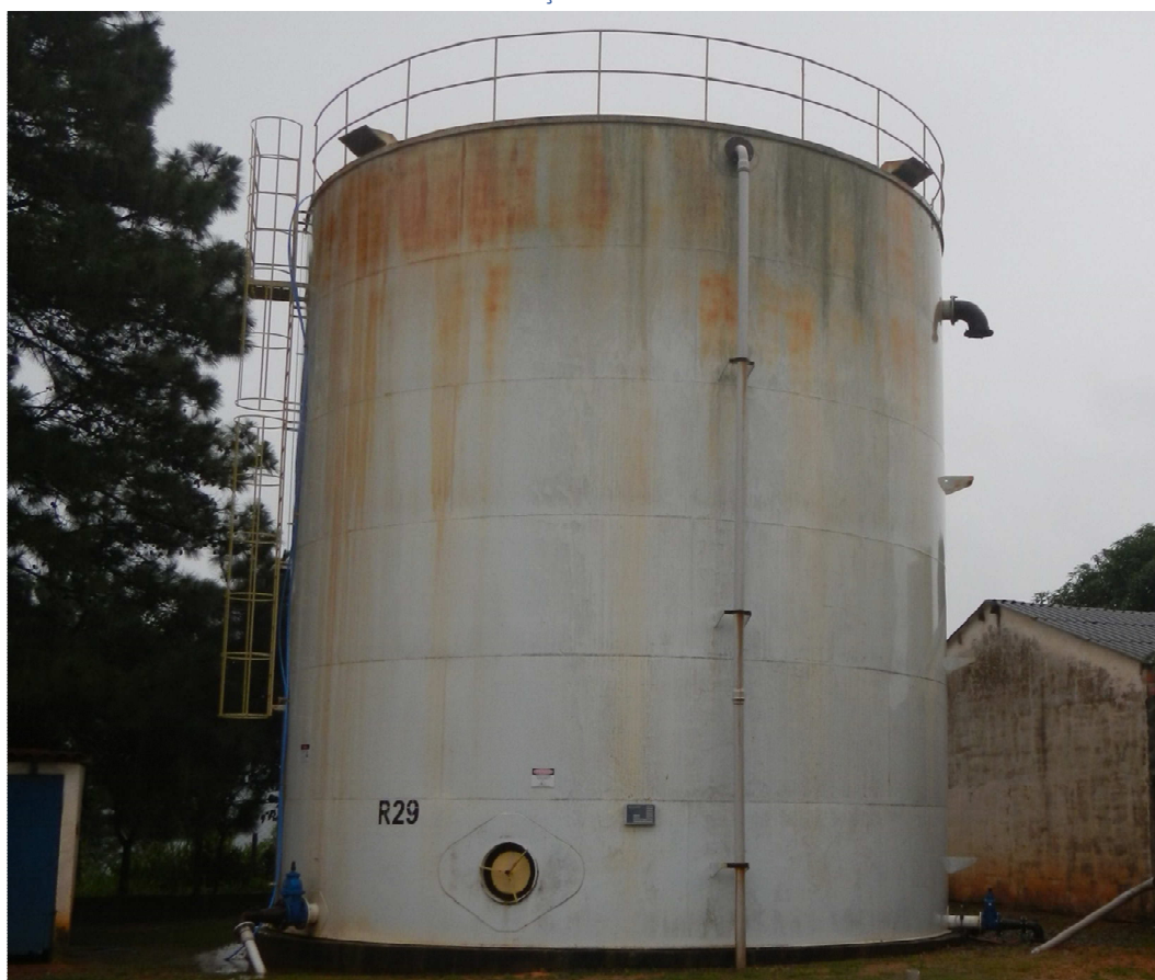
Vista do tanque metálico com 500m 3 de capacidade pertinente ao CR Dona Catarina.
