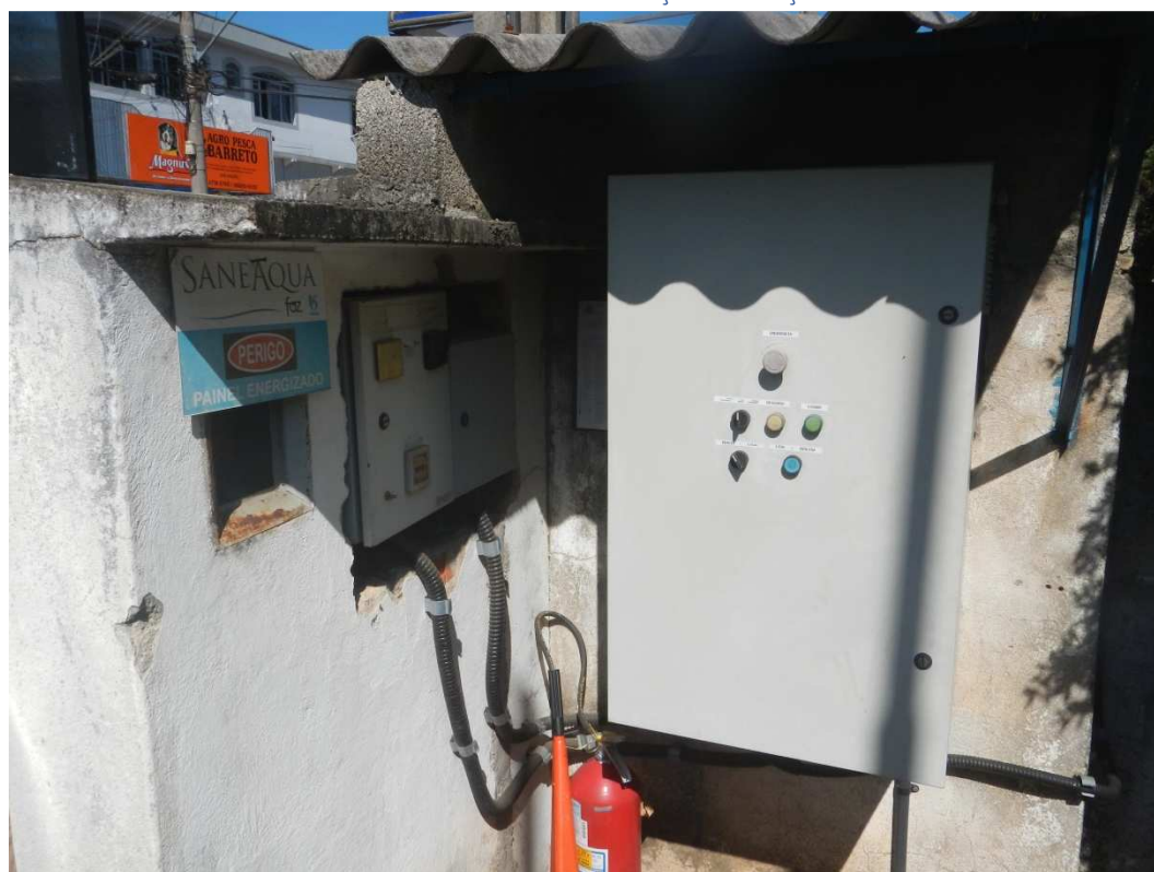
Vista do Quadro de Comandos do Poço P-9.
