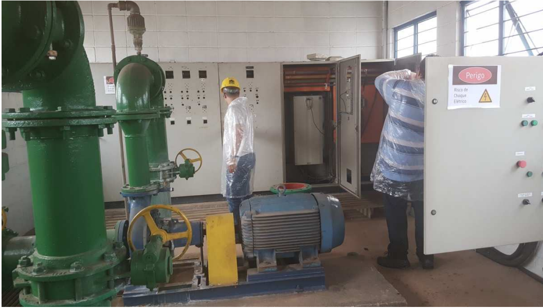
Vista do segundo conjunto moto bomba instalado na EEAT Ginásio e demais instalações.
