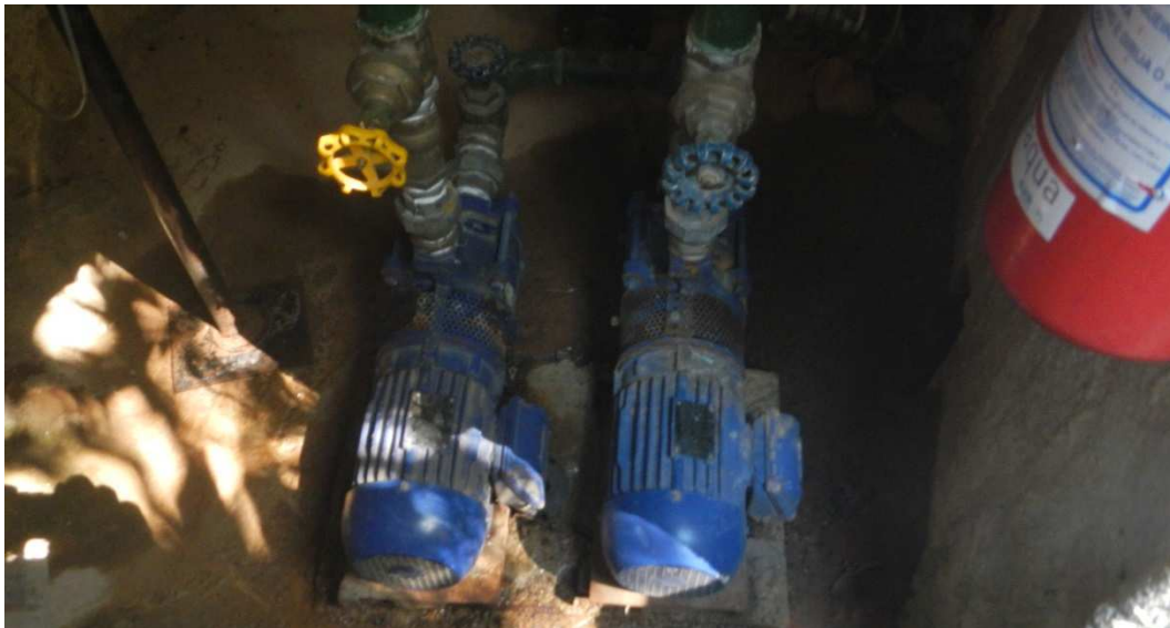
Vista do conjunto de moto bombas instaladas na EEAT – CR Bombeiro.
