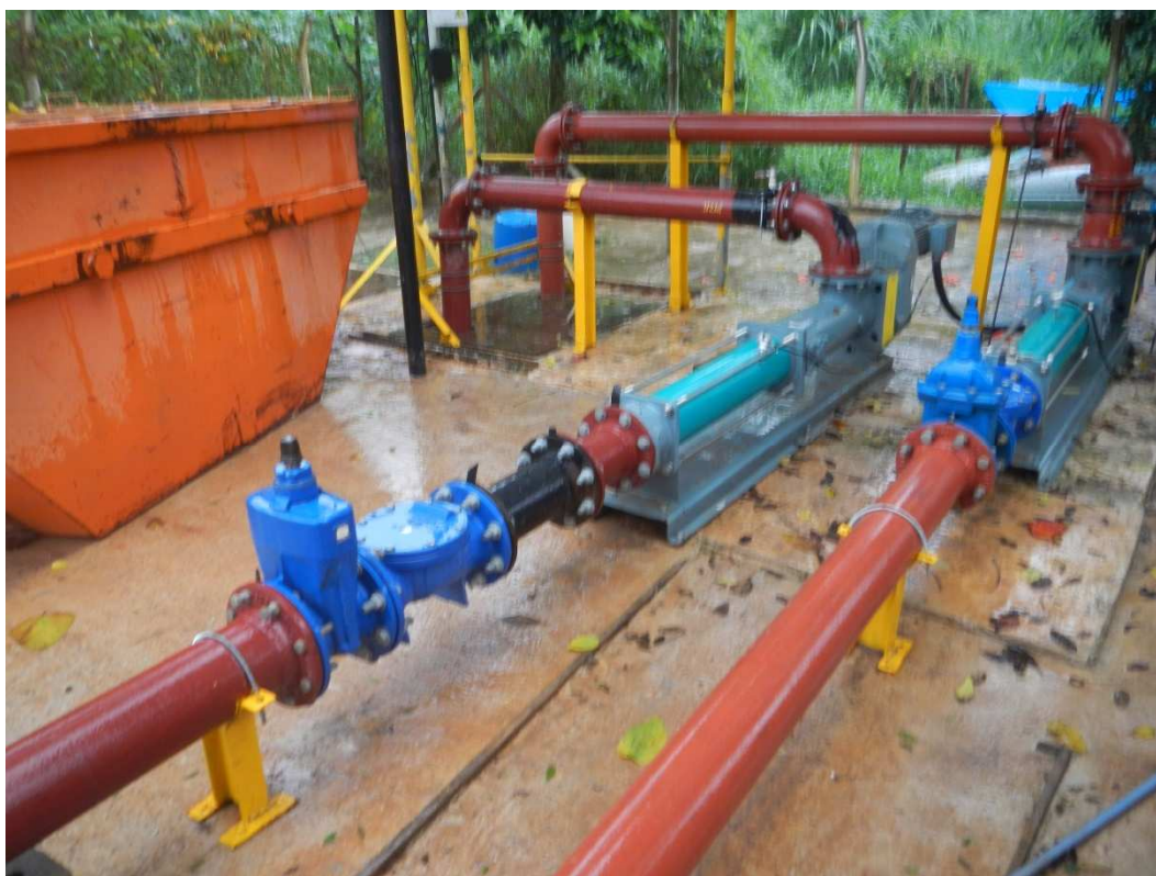
Vista das instalações da EEE Vitória.
