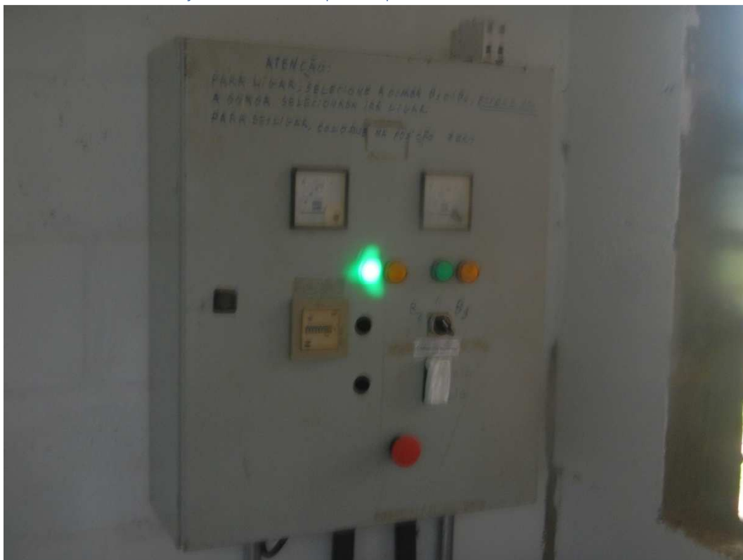
Vista interna das instalações da EEAT – CR Arco-íris.
