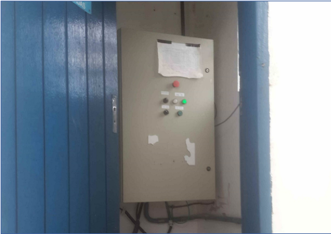
Vista do Quadro de Comando do Poço P-4.
