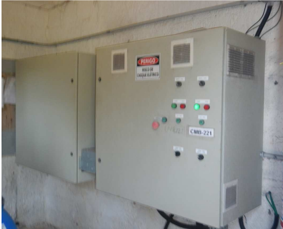
Vista do Quadro de Comando do Poço P-19.
