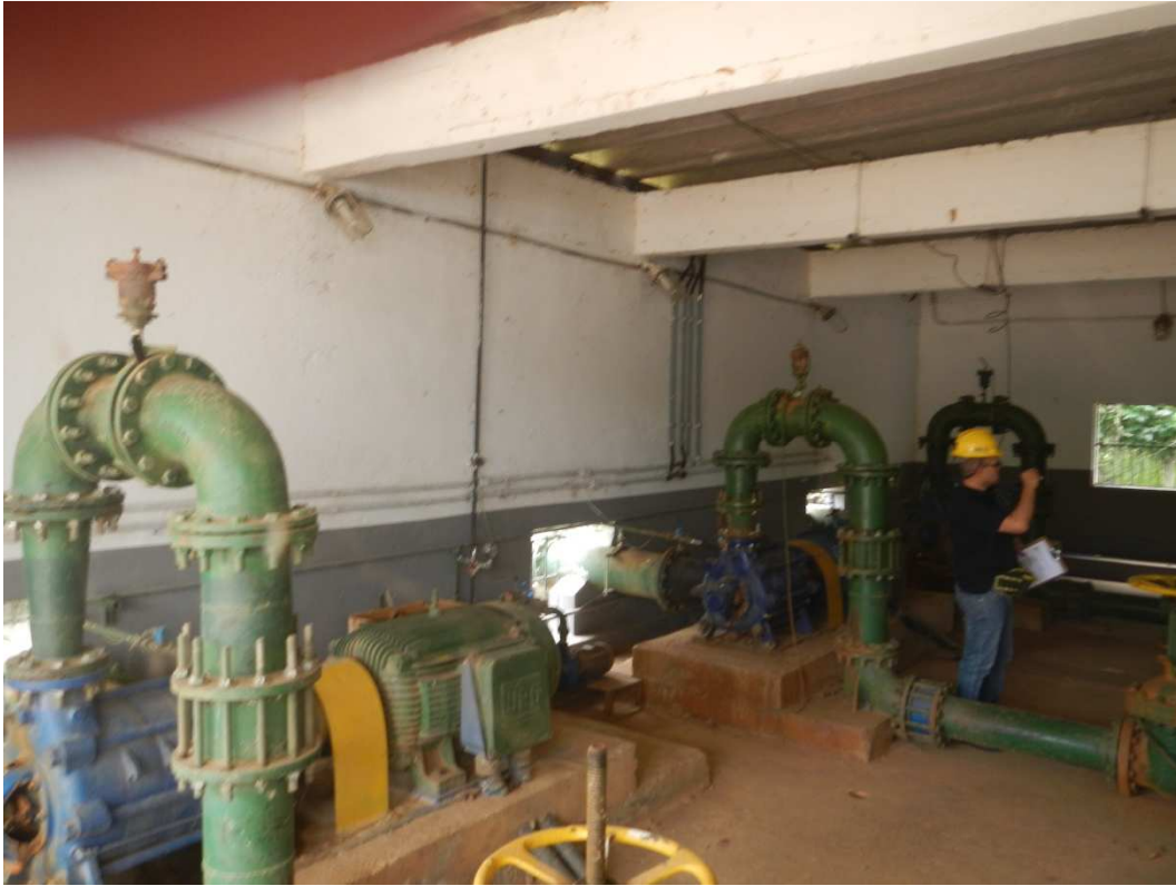
Vista do conjunto de equipamentos implantadas da EEAB Fiscal
