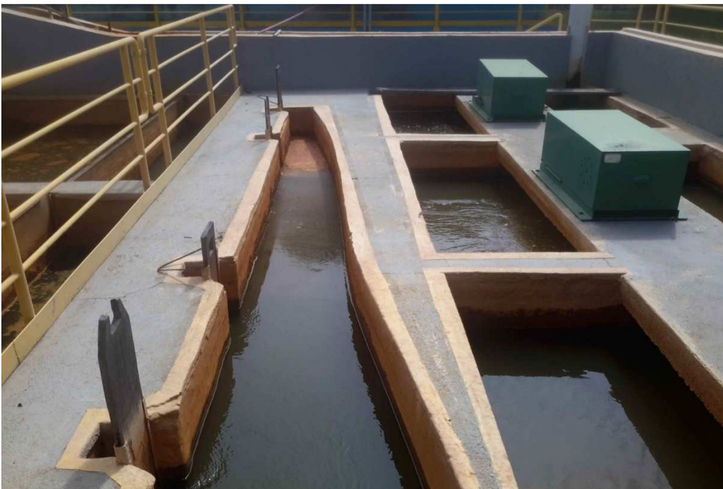
Vista Detalhe da Estação de Tratamento de Água - Floculadores
