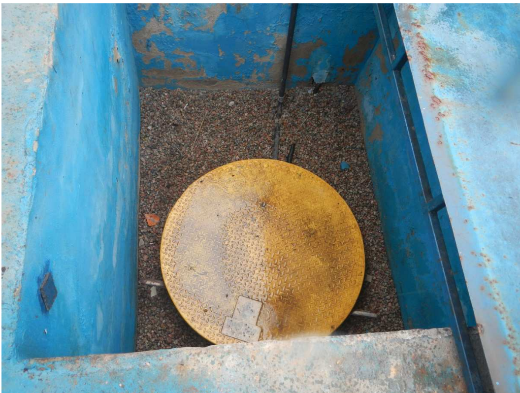
Vista interna das instalações da EEE Nova Mairinque.
