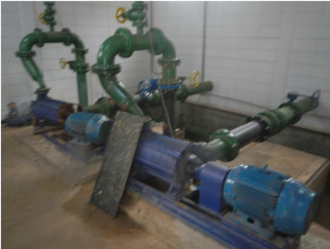
Vista do segundo conjunto de moto bombas instaladas na EEAT Waldez.
