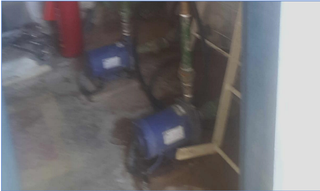
Vista do conjunto de moto bombas que compõem a EEAT – CR Recanto 2.
