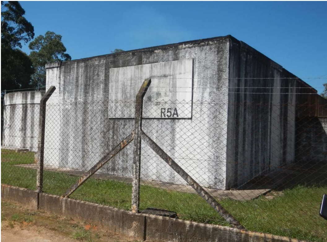
Vista do Reservatório R5A e R4 ao fundo à esquerda pertinentes ao CR Bombeiro.
