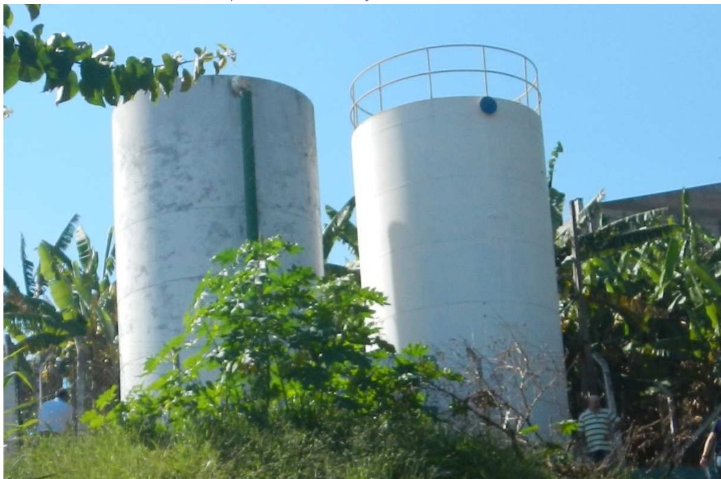
Vista dos reservatórios que compõem o CR Barreto do Meio.
