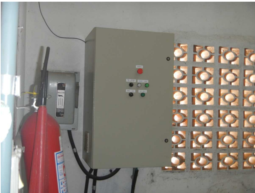
Vista do Quadro de Comando do Poço P-5.
