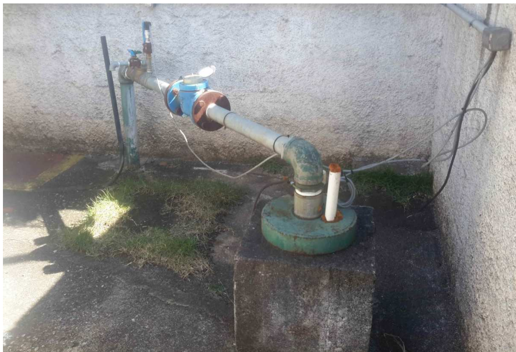
Vista das instalações do Poço P-9.
