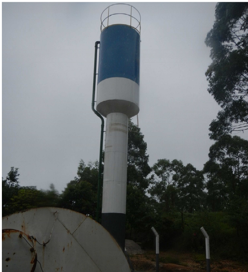
Vista do reservatório instalado no CR Santa Amélia.
