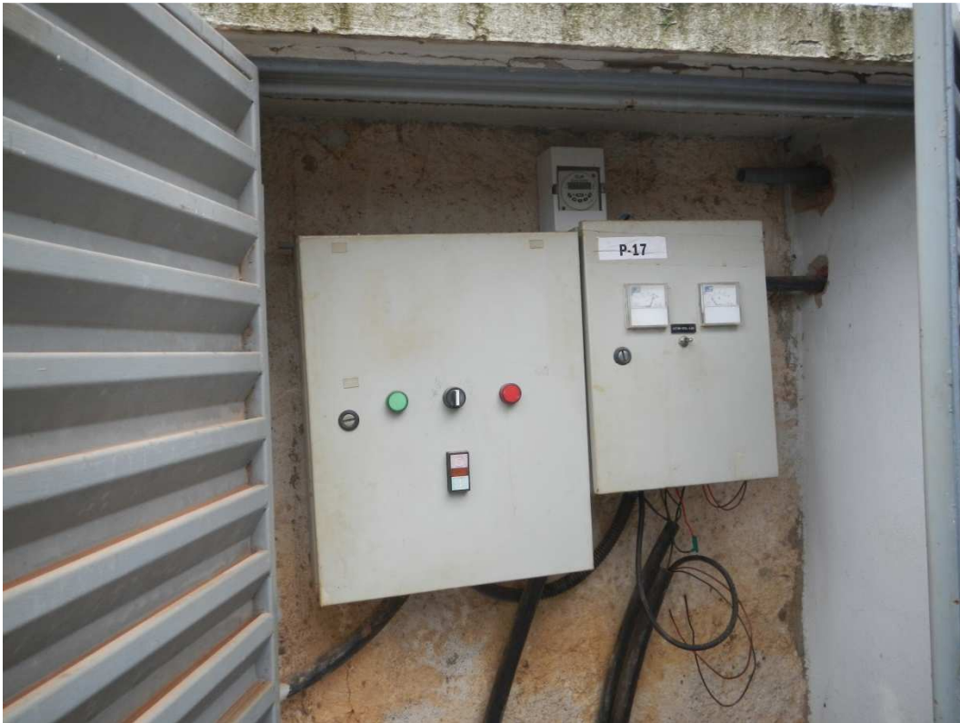
Vista do Quadro de Comando do Poço P-17b.
