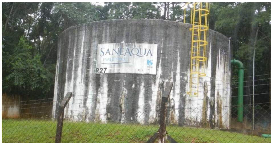
Vista de reservatório instalado na EEAT Waldez.
