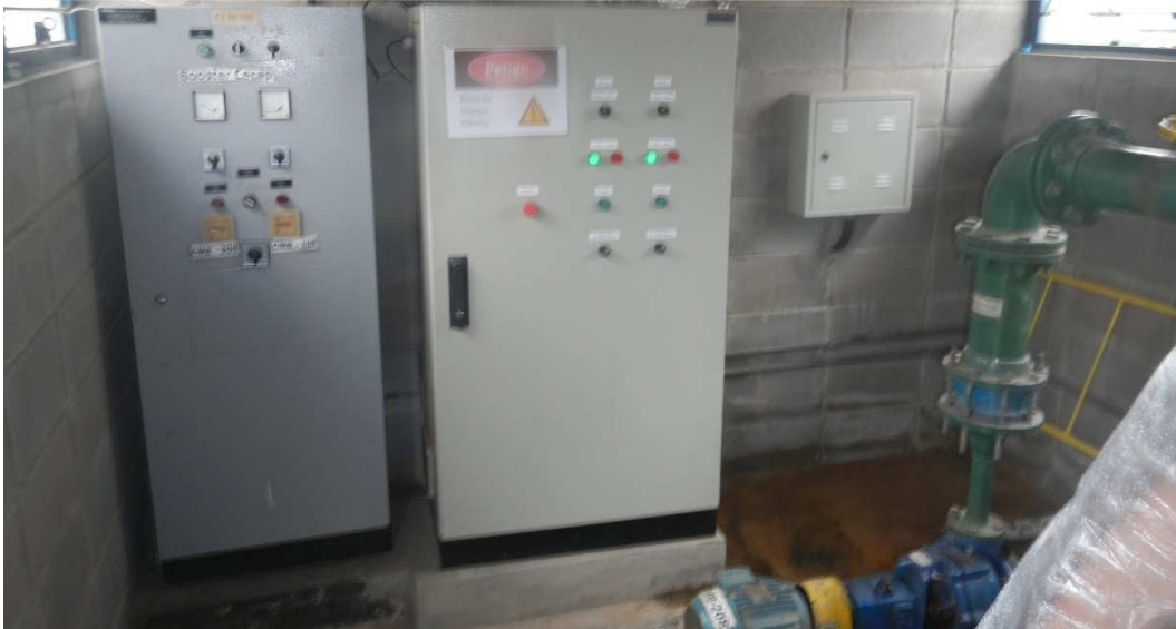
Vista interna das instalações da EEAT – CR-CECAP.
