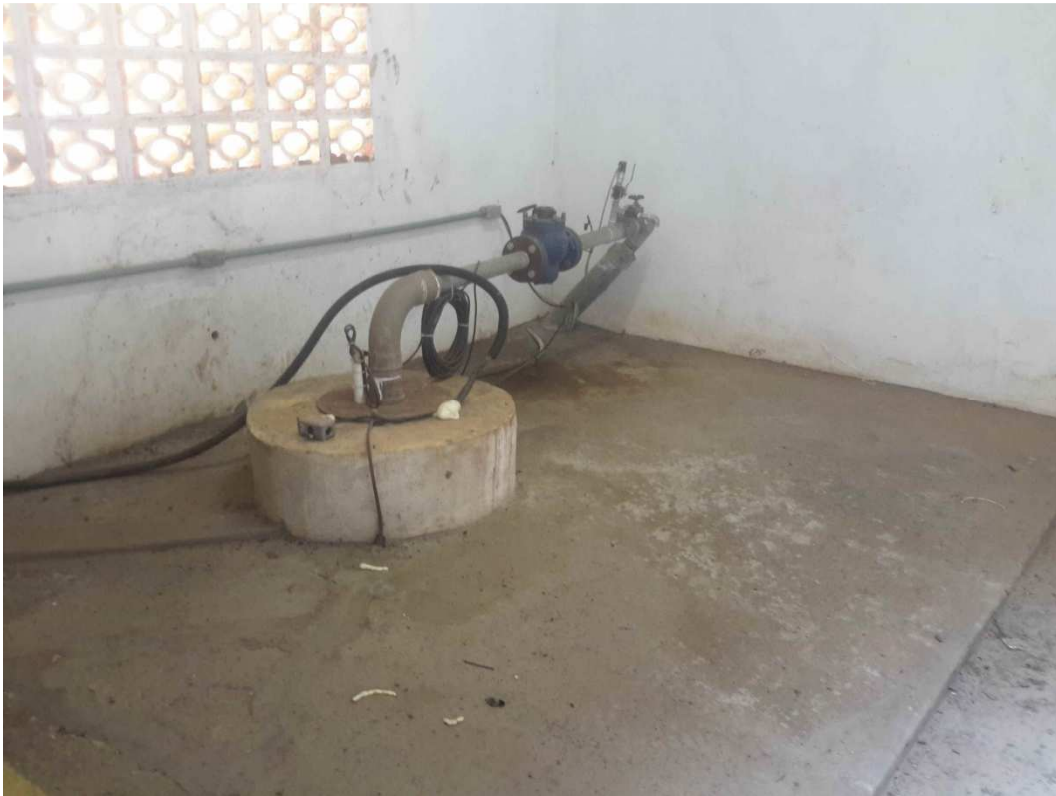
Vista das instalações do Poço P-5.
