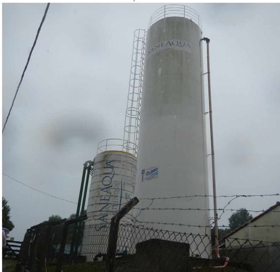
Vista dos reservatórios que compõem o CR Vitória ZB2.
