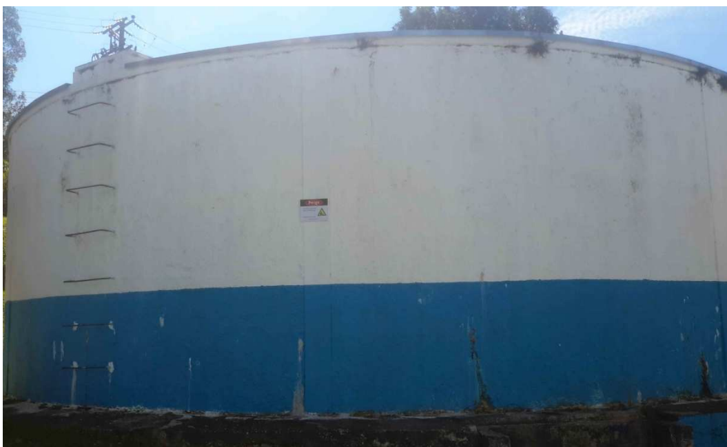
Vista do Reservatório implantado dentro da área da ETA.
