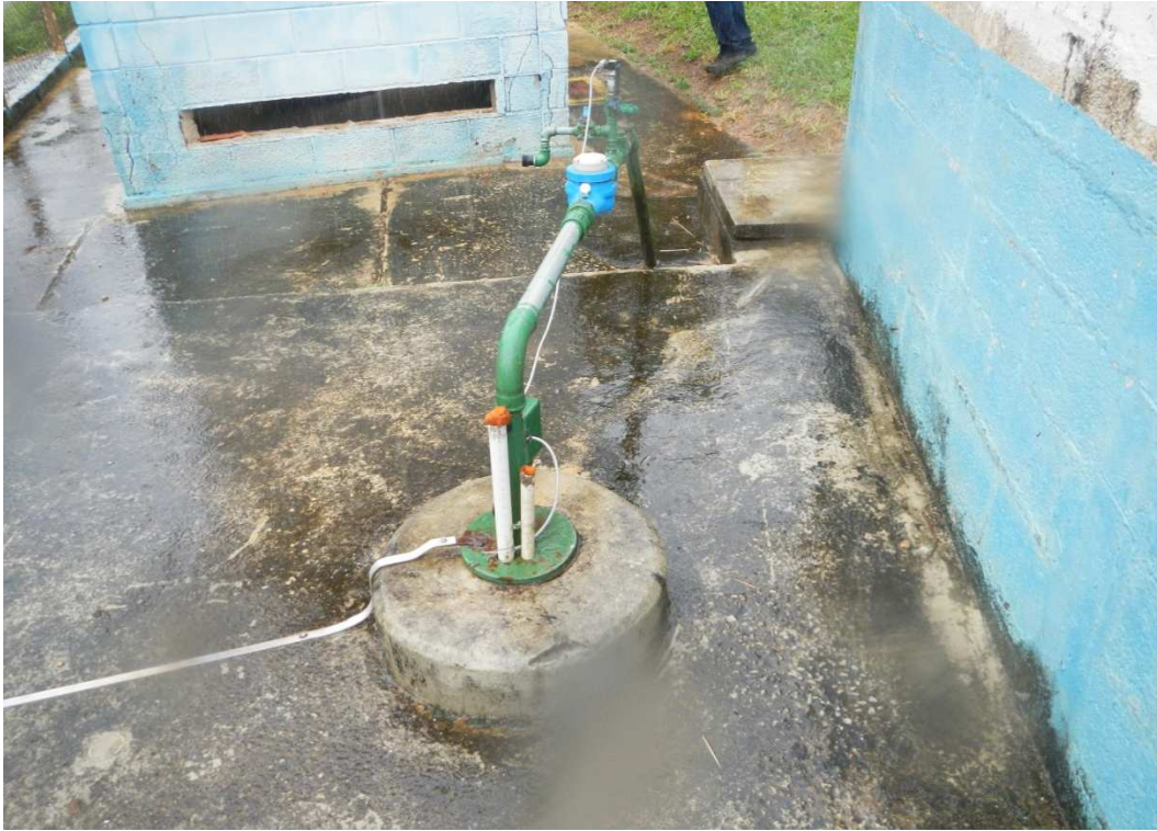
Vista das instalações do Poço P-11.
