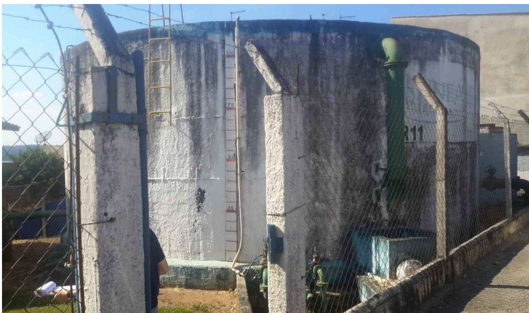
Vista do Reservatório R11 instalado nas dependências da EEAT Granada R-11.
