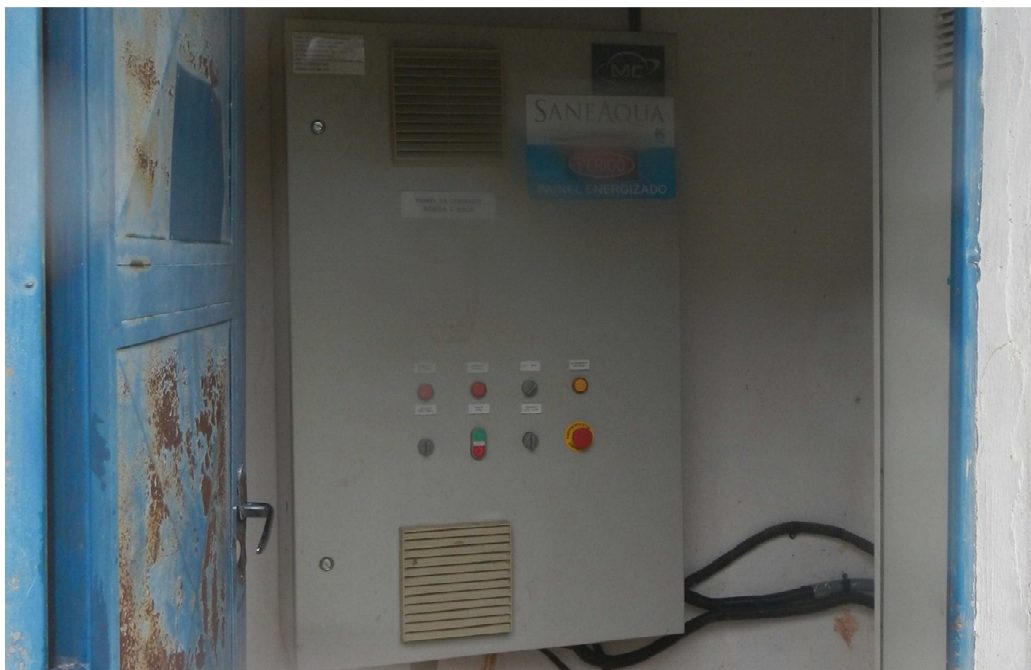
Vista do Quadro de Comandos do Poço P-17.
