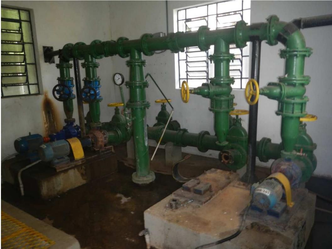
Vista do conjunto de equipamentos implantados da EEAB Carvalhal
