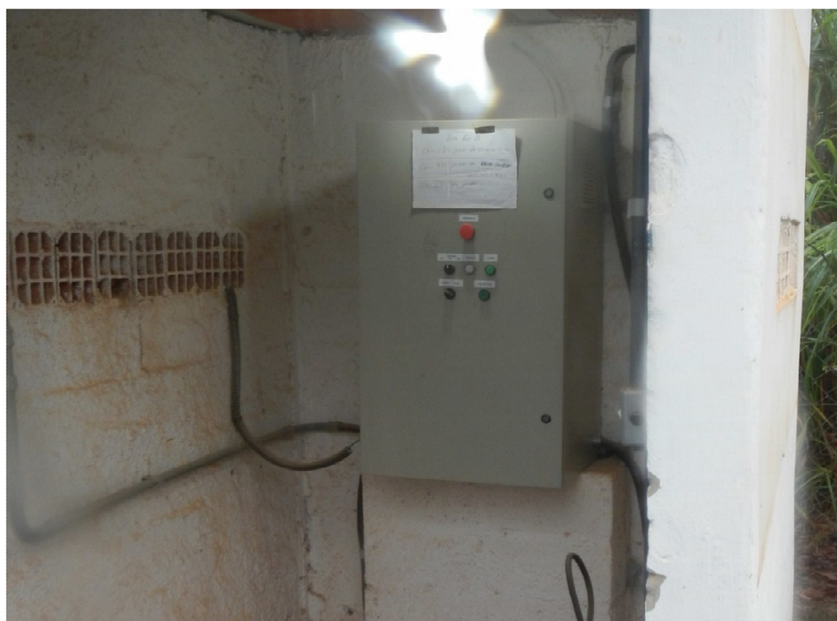
Vista do Quadro de Comando do Poço P-18.
