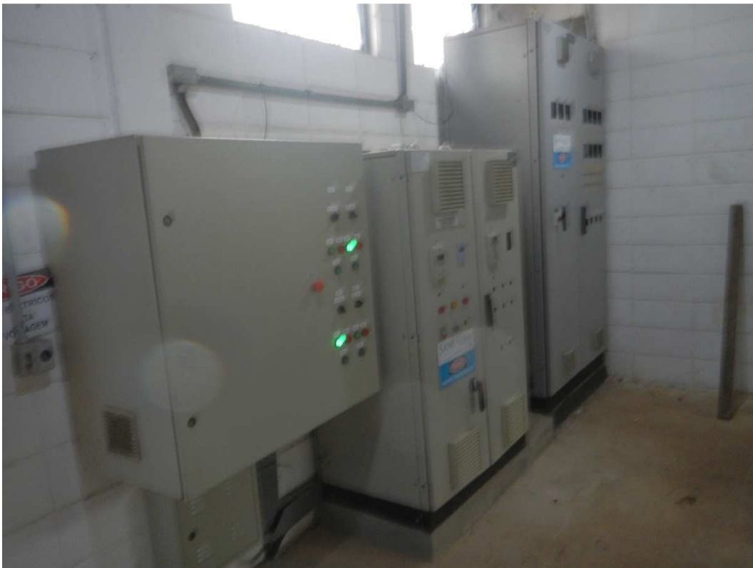
Vista interna das instalações da EEAT Waldez.
