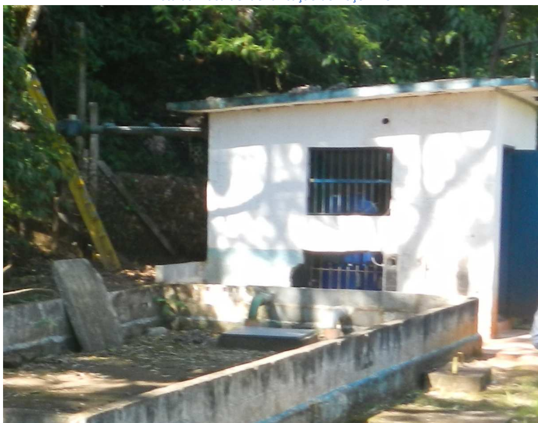
Vista das Instalações do Poço P-19.
