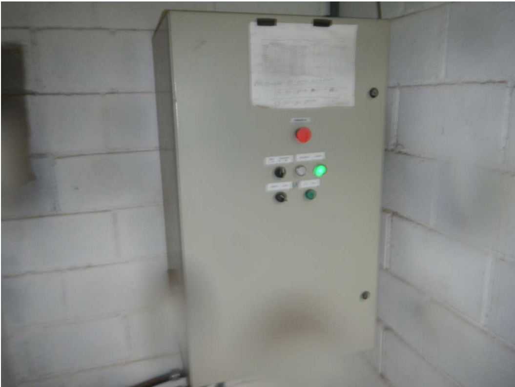
Vista do Quadro de Comando do Poço P-11.
