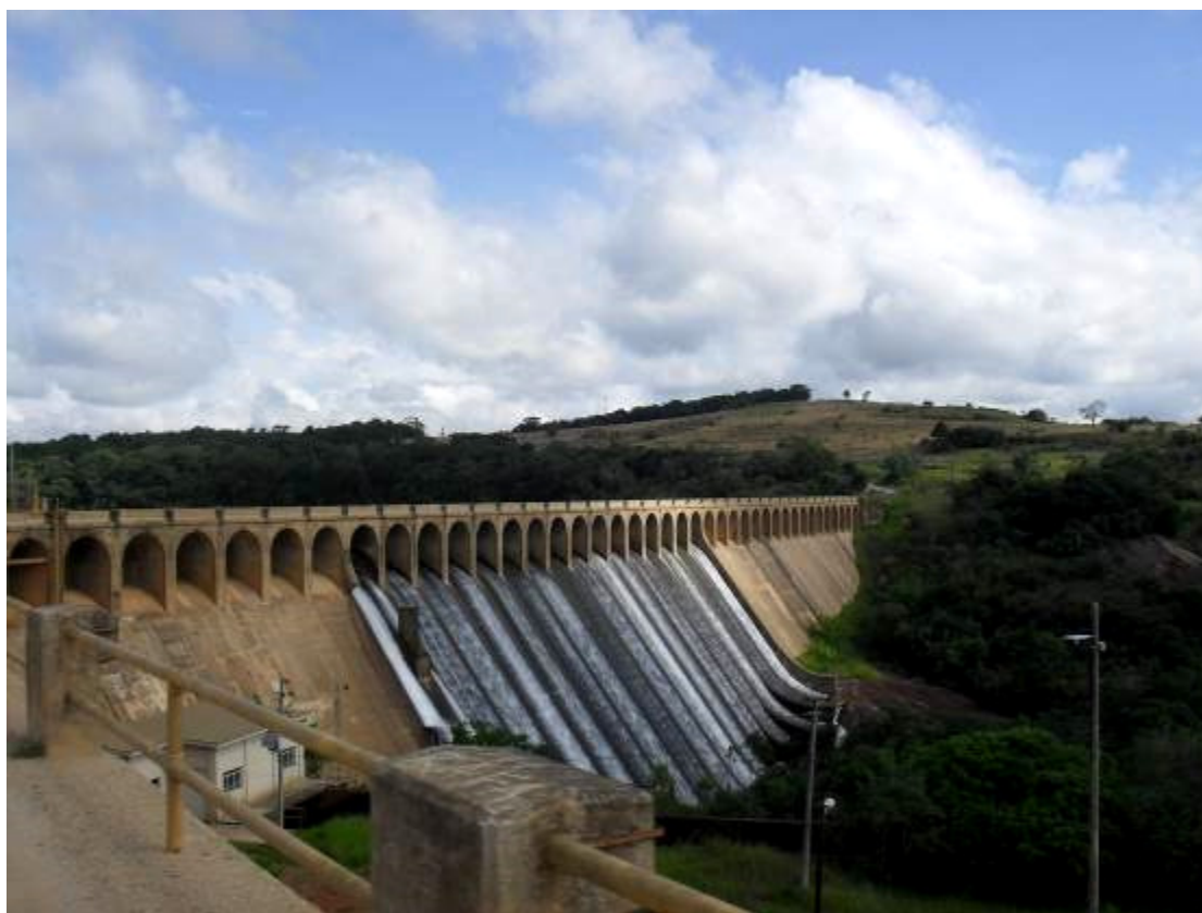
Figura 4 – Aspecto da barragem do reservatório de Itupararanga (SP) em episódio de vertimento de água. Data: fevereiro de 2010. Foto do autor
