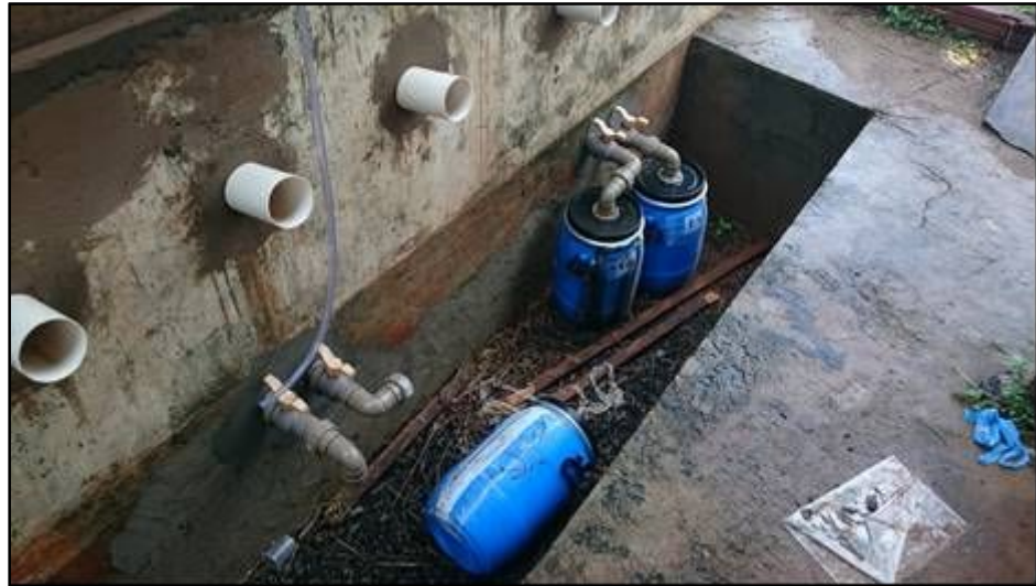
Figura 4. 7 - Bombonas para armazenamento e coleta de lixiviado
